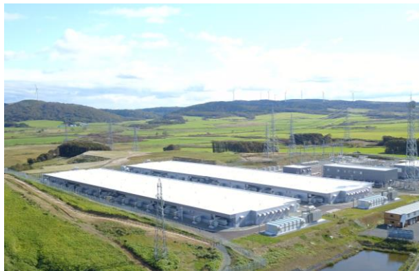
完成した蓄電池システム外観
