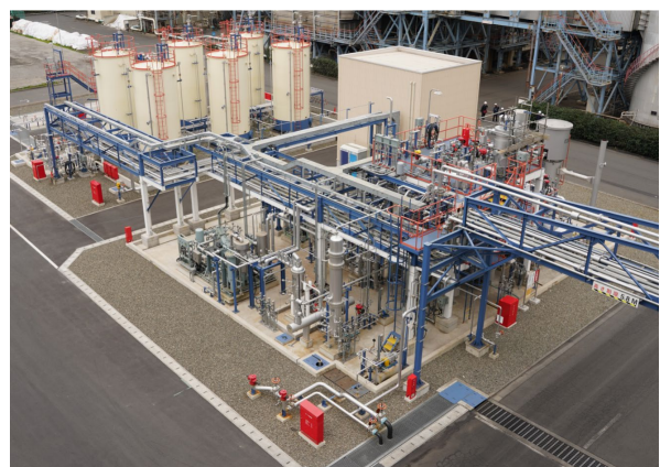
川崎脱水素プラント
