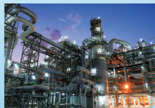
カタールガスII社 LNGプラント
