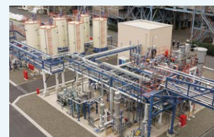
脱水素プラント(川崎臨海部)
