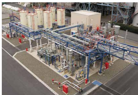
川崎臨海部の脱水素プラント
