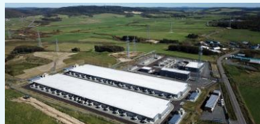
北海道北部風力送電株式会社向け 蓄電池システム
