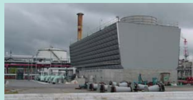
富士石油(株) No.8冷却塔プラント
