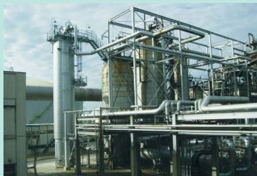
昭和四日市石油(株) HDS-3リアクター増設プラント
