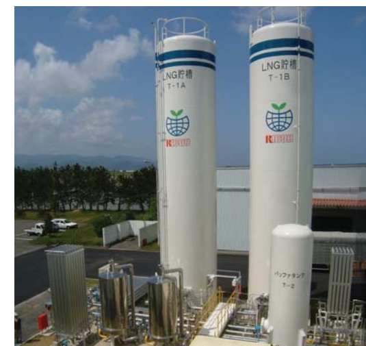
(株)リコー向けLNGサテライト基地
