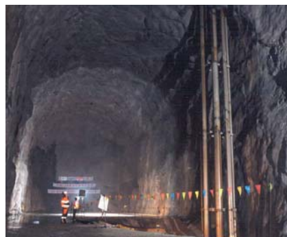
中国LPG岩盤貯蔵ターミナルのLPG貯槽
