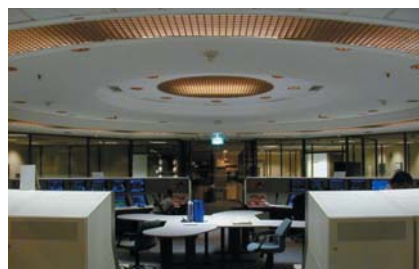
プラタミナLNG設備の計器室
