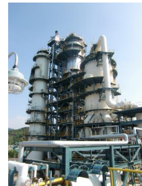
RFCC(残渣流動 接触分解)装置
