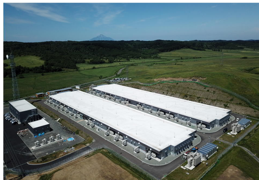
*2北豊富変電所蓄電池システム(建設中)
