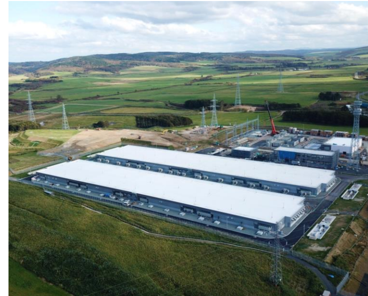
北海道北部風力送電(株)殿向け蓄電池システム建設現場(2020年10月撮影)
