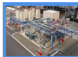
脱水素プラント@川崎臨海部
