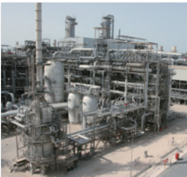
Qatargas 2, LNG Plant (Train 4) (Qatar)
